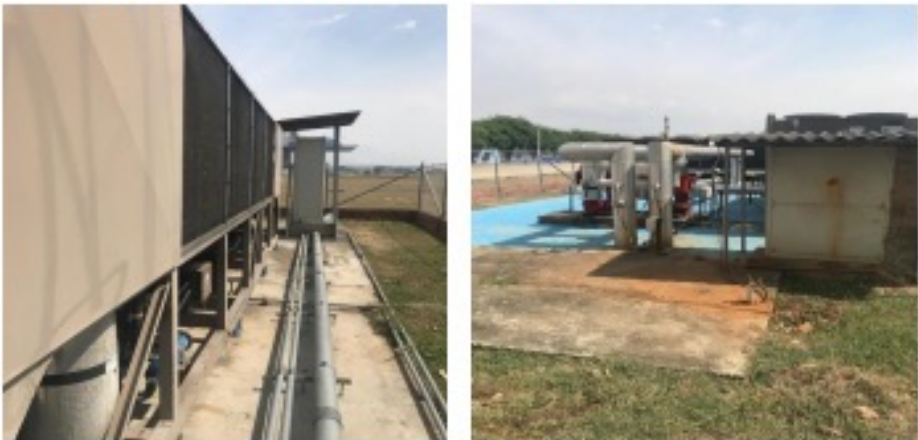
Figura 5. Sistema Aire Acondicionado Chiller
