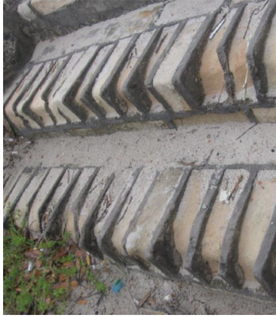
Figura 9. Escalones afectados por erosión causada por arena cerca a la playa. Fuente: John J. Coronado. Escuela de Ingeniería Mecánica. Grupo de Investigación en Fatiga y Superficies (GIFS) Universidad del Valle. Curso Postgrado: Desgaste de componentes mecánicos.
