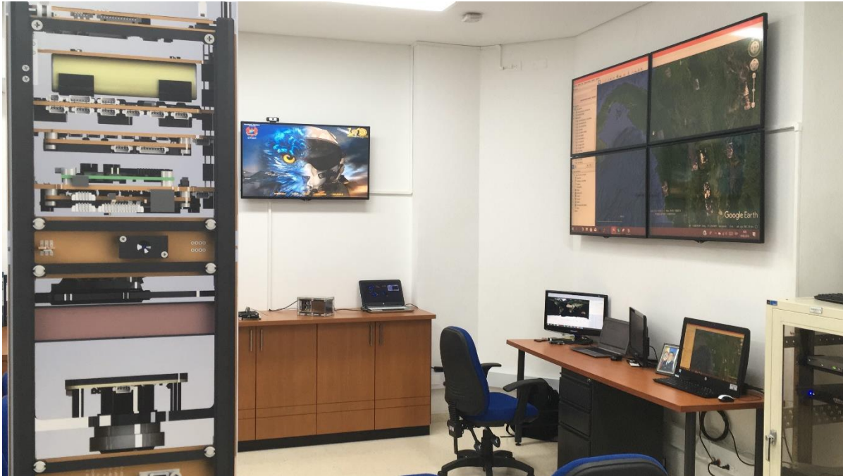
Ilustración 1. Estación Terrena FACSAT-1
